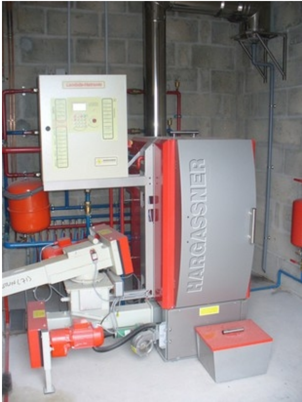
Illustration 3: Exemple de chaufferie de 35 kW
